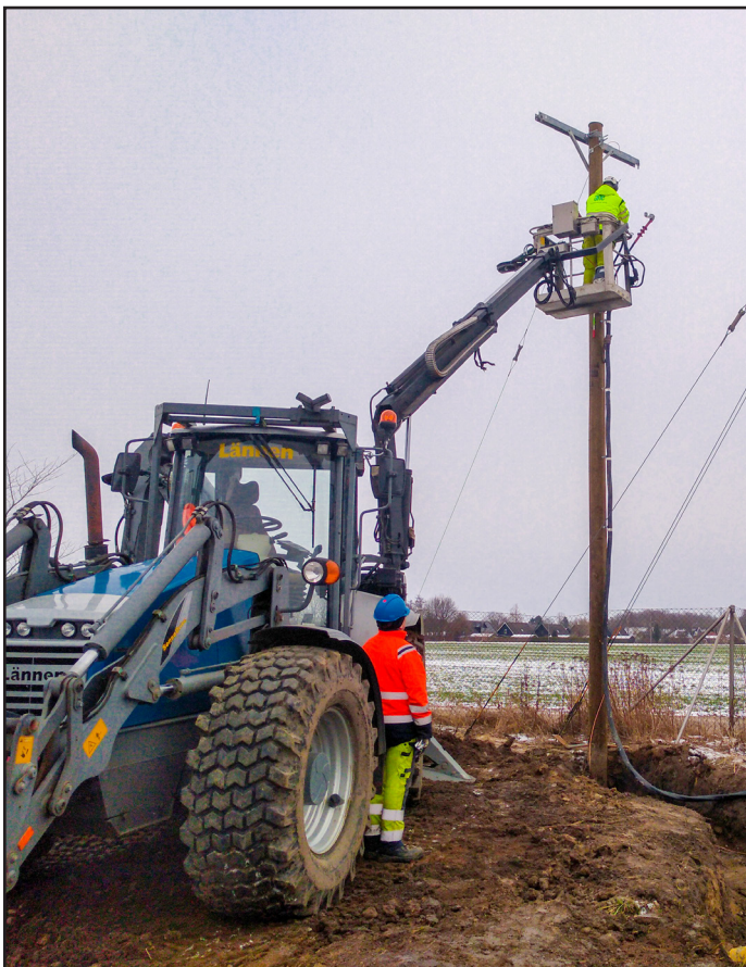
Via en egen elstolpe kopplas elektricitet in till behandlingsanläggningen. Elförbrukning för sju månaders behandling beräknas till drygt 9 miljoner kWh.
