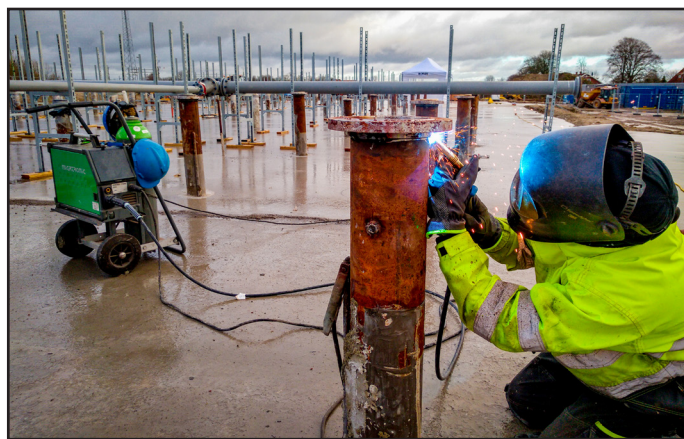
Montering av utrustning ovan mark i den termiska anläggningen - på bilden svetsas ett av foderrören som innehåller värmespiraler.
